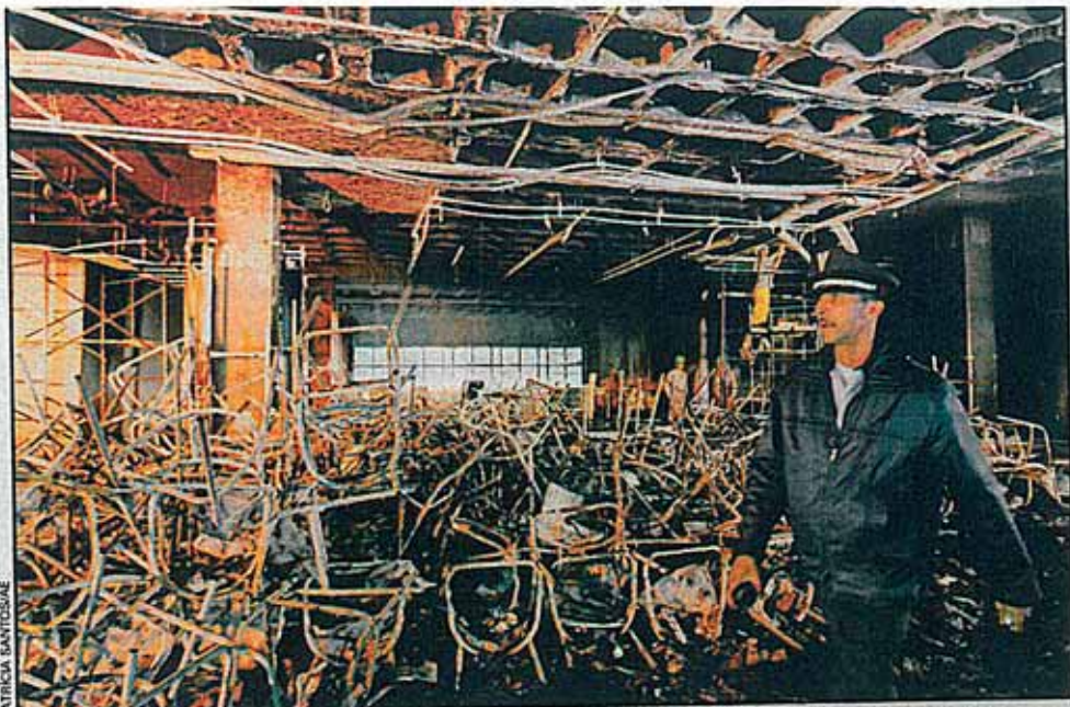
O andar do novo terminal incendiado: falta de fiscalização na obra
