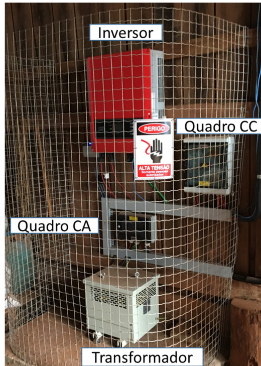
Figura 5.17. Equipamentos de conversão CC/CA instalados na propriedade cooperada da LAR. Também se mostra o sistema de aquisição e armazenamento de dados (PHB Logger).
