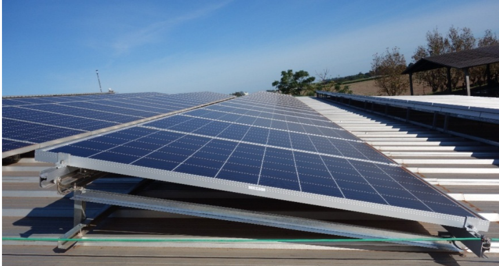
Figura 5.15. Inclinação dos módulos FVs sobre o telhado do galpão, para atingir uma inclinação de 18^\circ em relação a horizontal.
