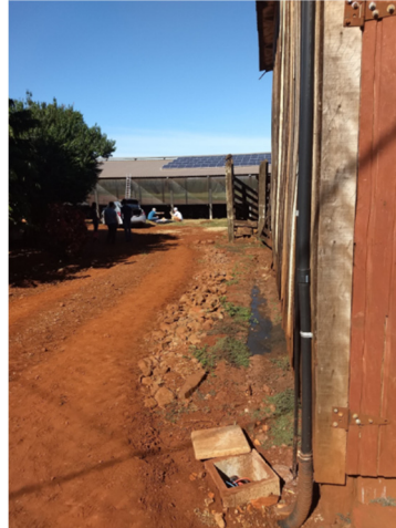
Figura 5.11. Caminho da tubulação enterrada e caixas de passagem na parte superior do terreno. O arranjo FV pode ser visto ao fundo.
