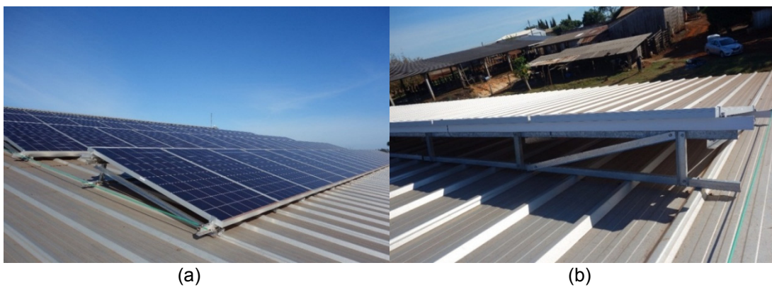
Figura 5.14. Arranjo fotovoltaico: (a) vista lateral-frontend e (b) vista posterior de uma fileira de módulos fotovoltaicos.
