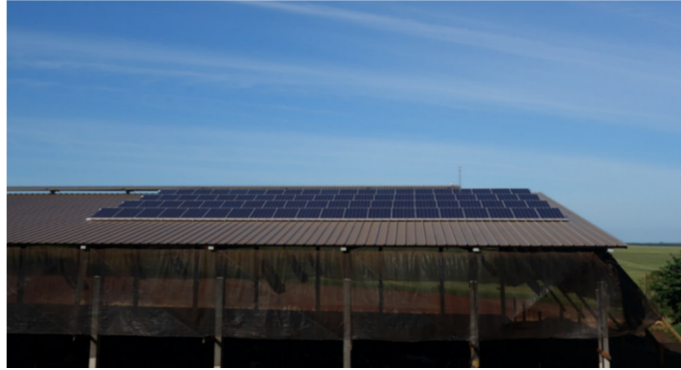
Figura 5.13. Arranjo FV no telhado do galpão da propriedade cooperada da LAR.
