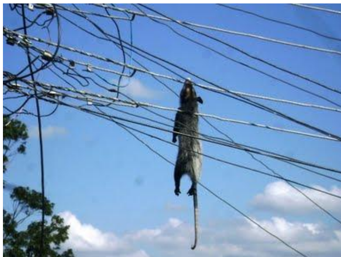
Figura 2-4: Gambá na rede elétrica
