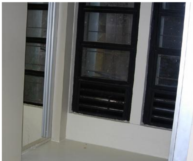
FIGURA A4.5: Janela de inspeção, à esquerda, permite acesso à parte traseira dos equipamentos.
