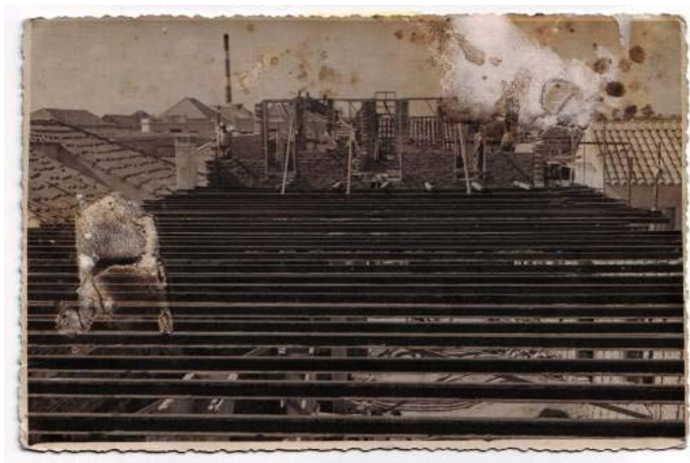
Fotografia 28 - Construção da Nova Sede do Clube Fica Aí . 1953. Fotógrafo Desconhecido. Acervo Rubens Lima.
