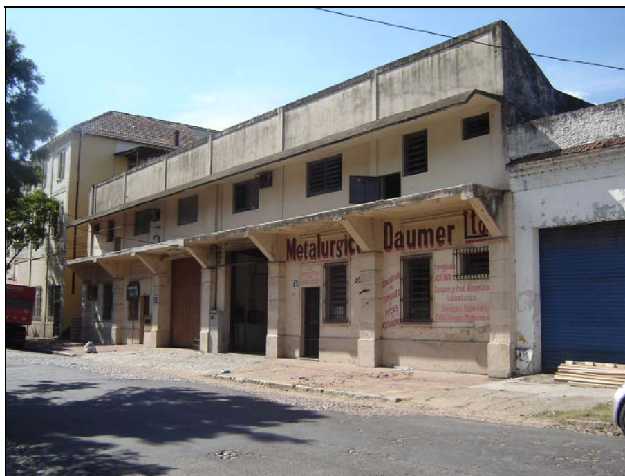
Figura 69 - Foto atual(janeiro de 2009) da edificação da Moura Azevedo, visivelmente alterada. Fonte: Fotografia da autora.
