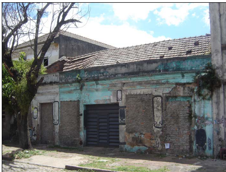
Figura 176 - Fotografia atual (janeiro de 2009) de casas de operários vazias e em ruínas na rua Rio Grande. Fonte: Foto da autora.
