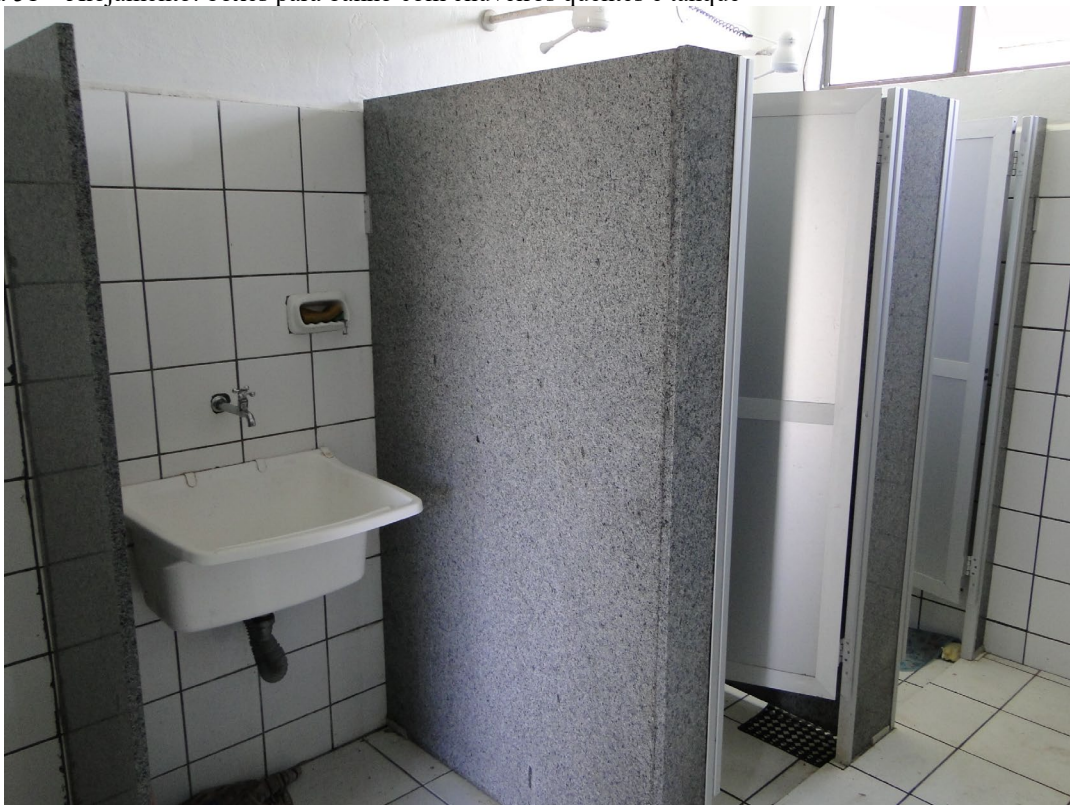
Figura 51 – Alojamento: boxes para banho com chuveiros quentes e tanque
