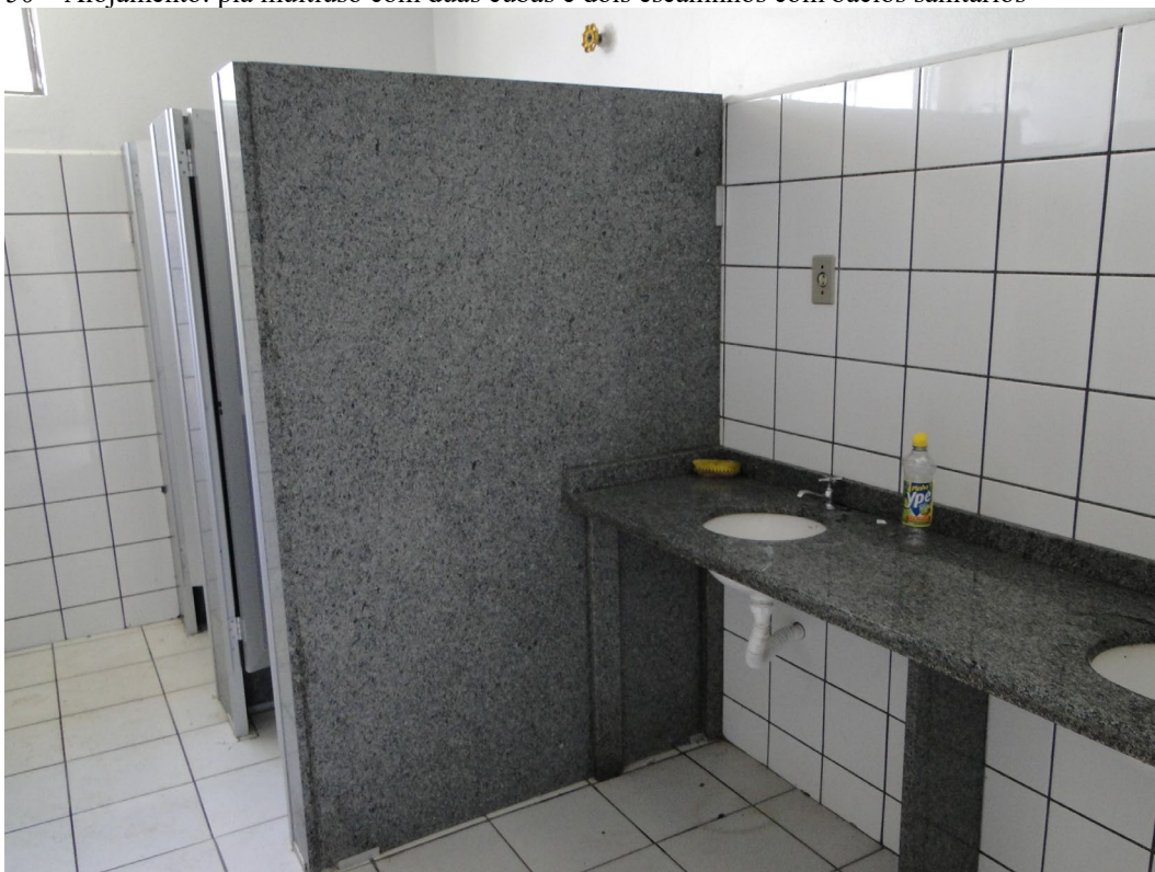
Figura 50 – Alojamento: pia multiuso com duas cubas e dois escaninhos com bacias sanitárias
