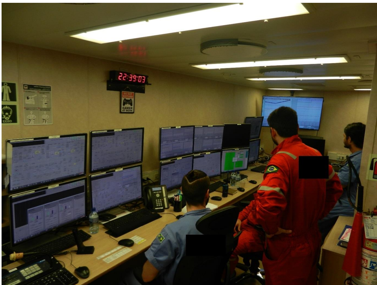
Imagem 6 – Central Control Room (CCR)
