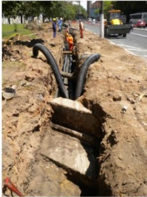
Figura 01 - Mureta que dividia a área da praça com a Rua Vasco Alves evidenciada durante a escavação da vala.
