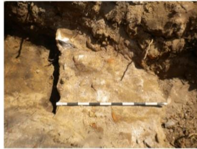
Figura 02 - Detalhe da superfície de destruição da parede evidenciada.
