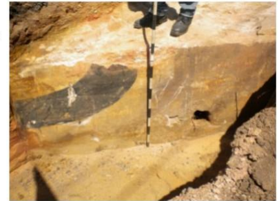
Figura 06 - Face externa da estrutura do antigo cais da Praça da Harmonia, a esquerda vestígios de letra pintada na estrutura e a direita orifício de sistema de drenagem.
