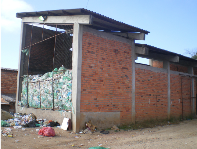
Galpão 2 – Triagem lixo hospitalar
