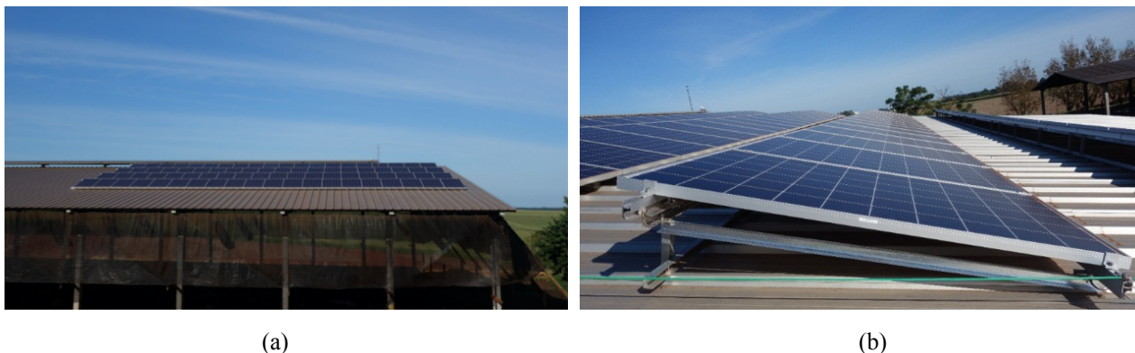
Figura 1 - (a) Arranjo fotovoltaico instalado na propriedade rural em Medianeira-PR e (b) detalhe da instalação dos módulos fotovoltaicos, com inclinação de 8^\circ sobre um telhado inclinado de 10^\circ para atingir o ângulo de 18^\circ para a maior produtividade anual para a região de Medianeira, PR (Araujo b et al. , 2018; Moehlecke et al. 2019)
