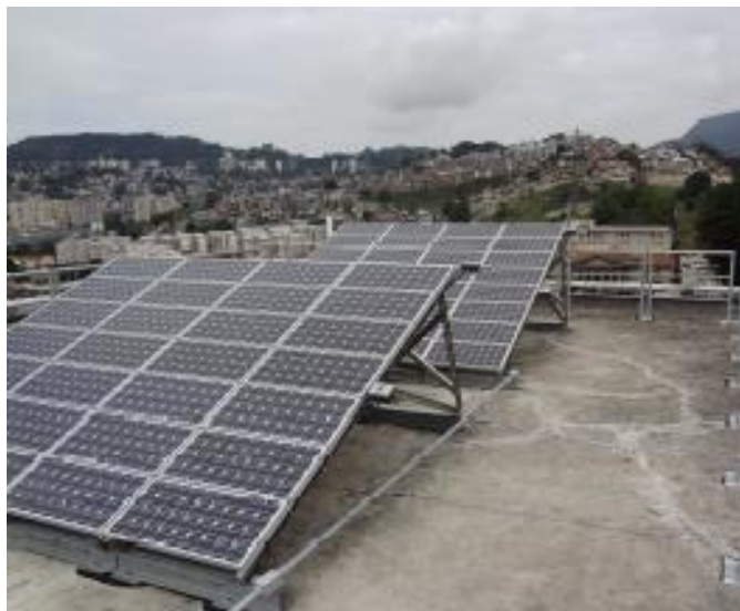
Figura 18 – Arranjo fotovoltaico com os módulos produzidos em escala piloto, instalado na Universidade Petrobras, no Rio de Janeiro.
