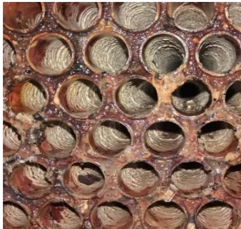
Figura 3. Incrustações em trocadores casco e tubos. Fonte Ferreira, Leon. (2019).
