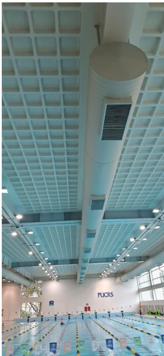
Figura 7 – Dutos utilizados atualmente no ambiente.
