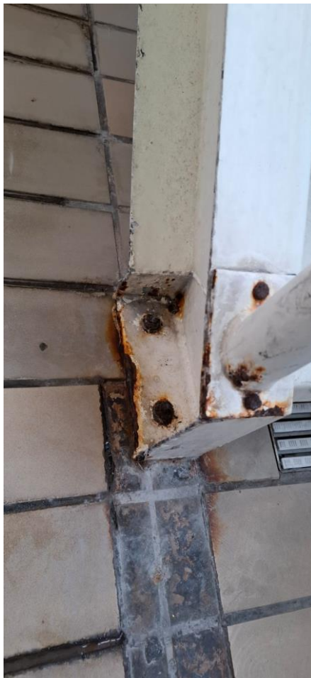
Figura 5 – Oxidação aparente na escada de acesso.
