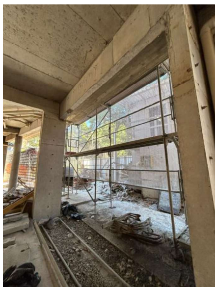
Figura 25: Risco de queda de pessoas
