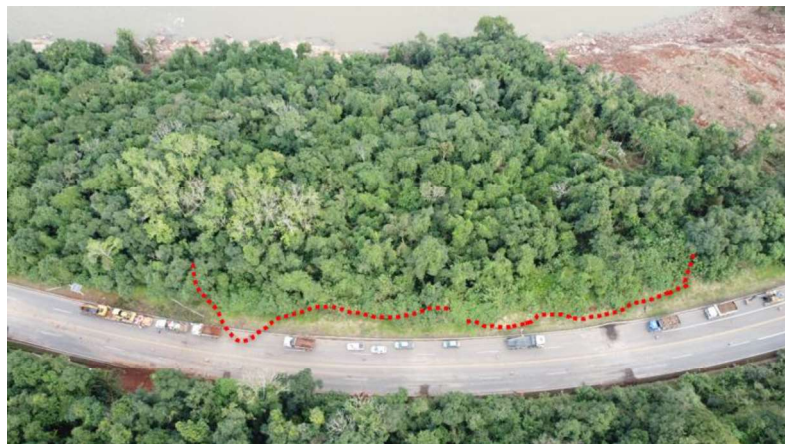
Figura 5: Talude estudado com indicação de trincas.
