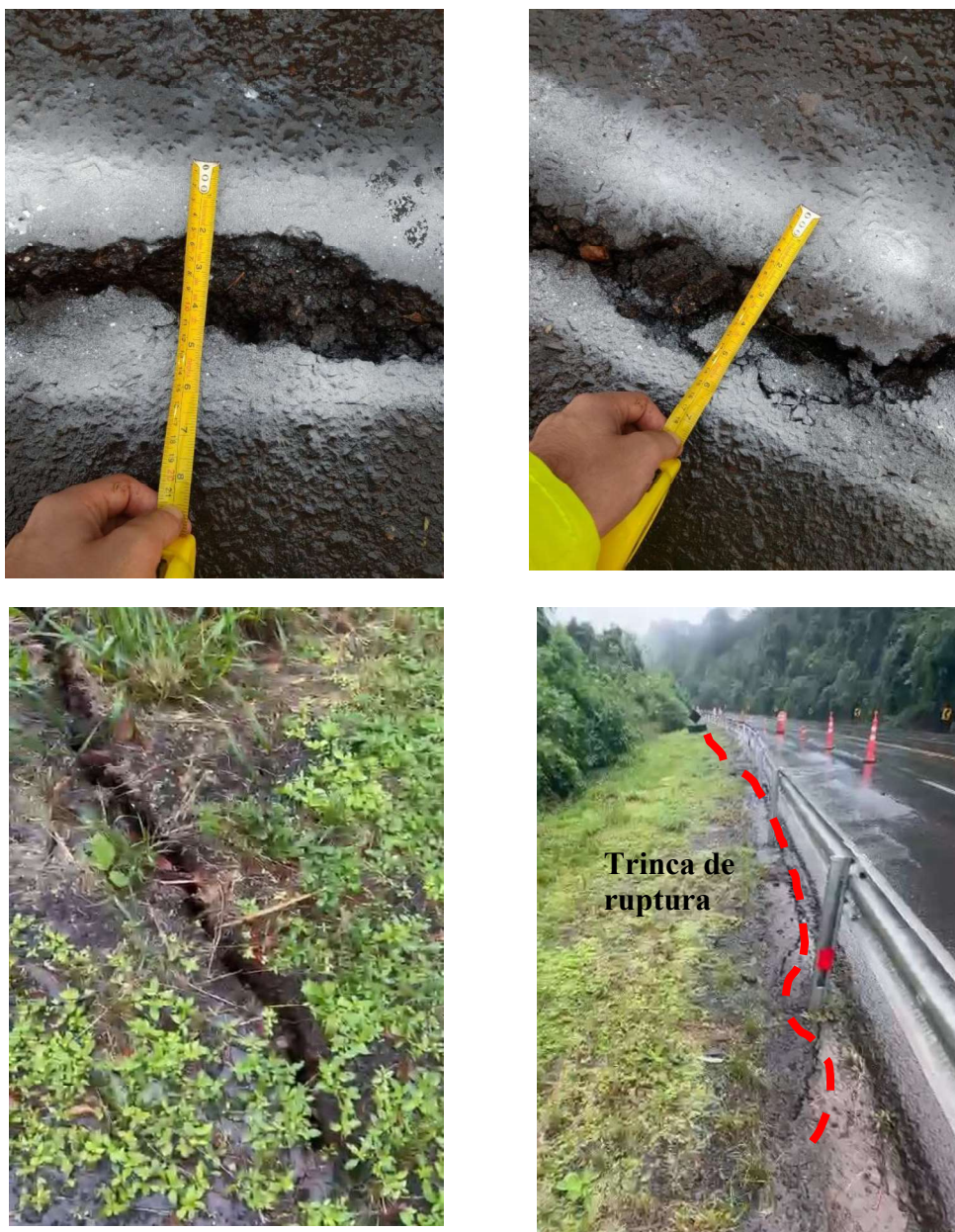
Figura 13: Trinca de ruptura
