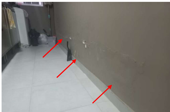
Figura 11: Presença de bolhas no revestimento interno das paredes do apartamento
