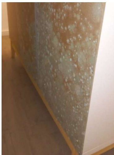
Figura 12: Presença de bolor atrás dos móveis do apartamento
