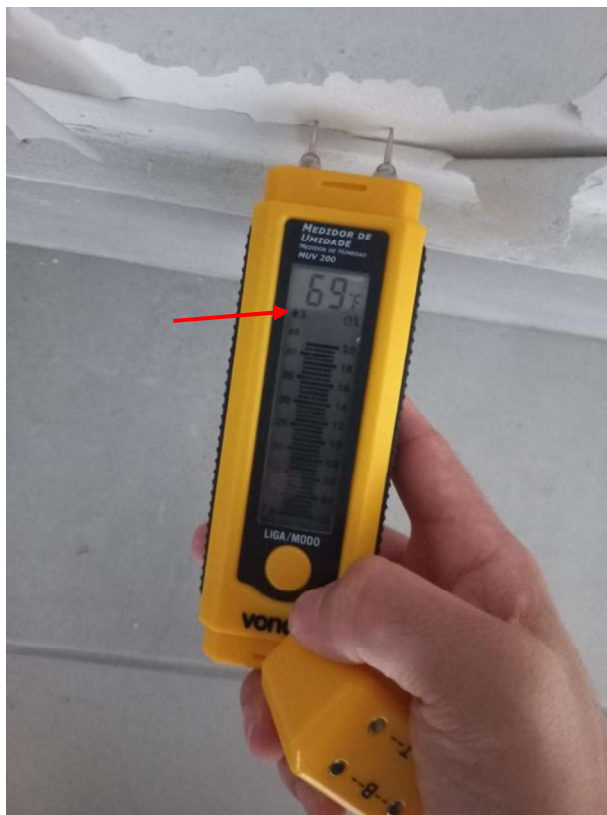
Figura 13: Aparelho utilizado para medir a umidade nas paredes comprometidas do empreendimento em estudo, indicando níveis elevados de umidade, conforme registrado no indicador
