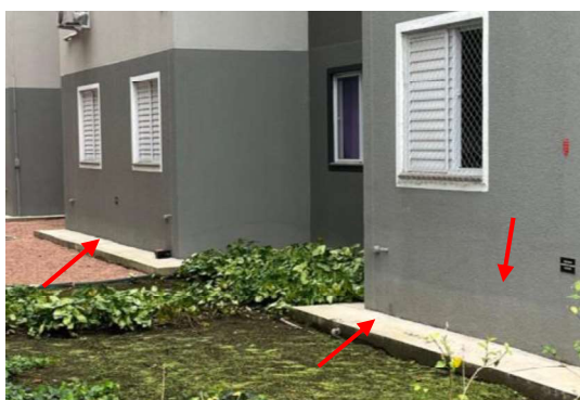
Figura 10: Manchas no revestimento externo do empreendimento em estudo devido à presença de umidade ascendente
