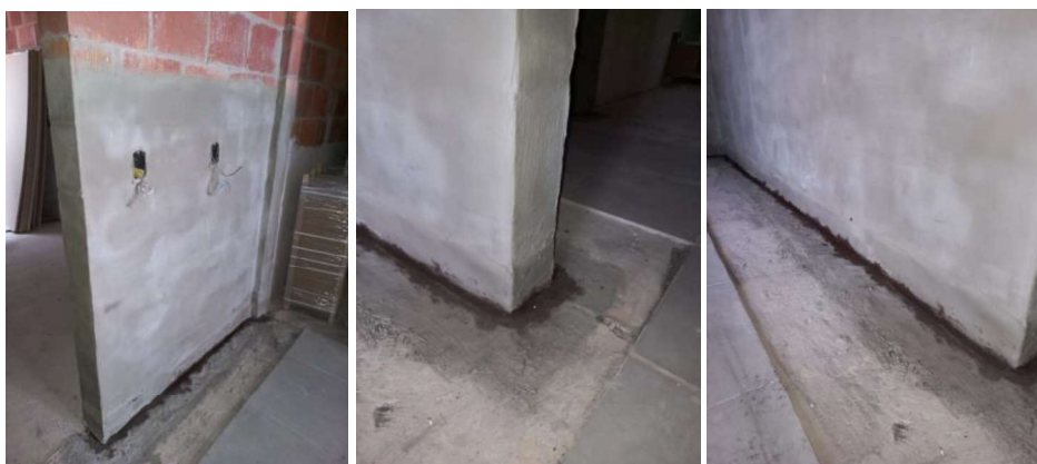
Figura 19: Presença de umidade após a aplicação das argamassas
