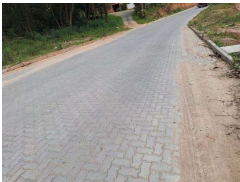
Apêndice A 2: Encontro de materiais diferentes sem contenção
