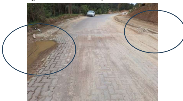
Figura 22: Defeitos em pavimentos intertravados
