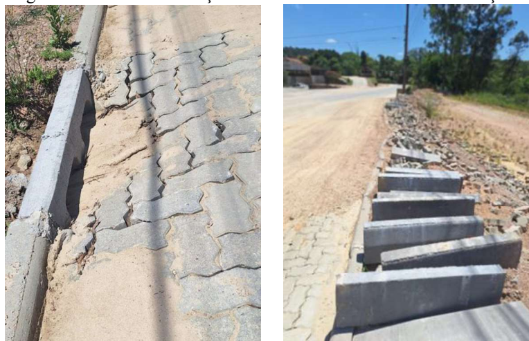
Figura 25: Falta de contenção interna e deslocamento das contenções laterais
