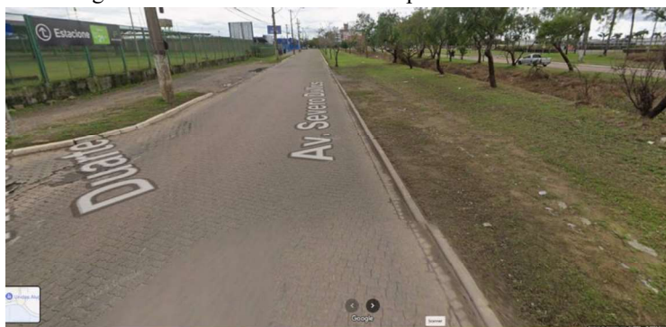
Figura 4: Pavimento intertravado após enchente de maio
