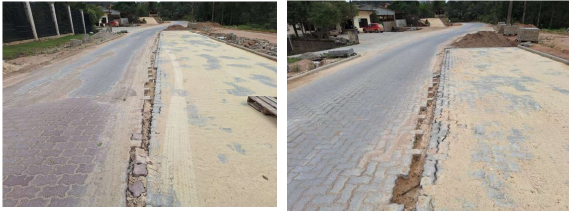
Figura 24: Manutenção de trecho com defeitos (a) e falta de contenção lateral (b)
