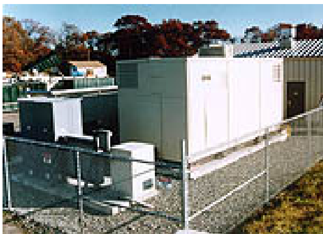
Figura 1.11: Estação geradora PC-25.
