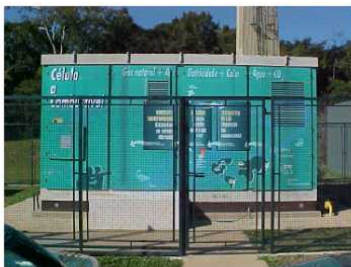
Figura 1.5: Estação geradora PC-25 instalada no Paraná. Fonte: [13]
