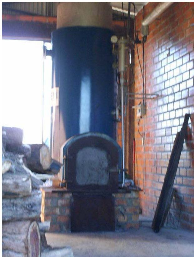
Figura 4.3. Gerador de vapor da unidade industrial – caldeira.
