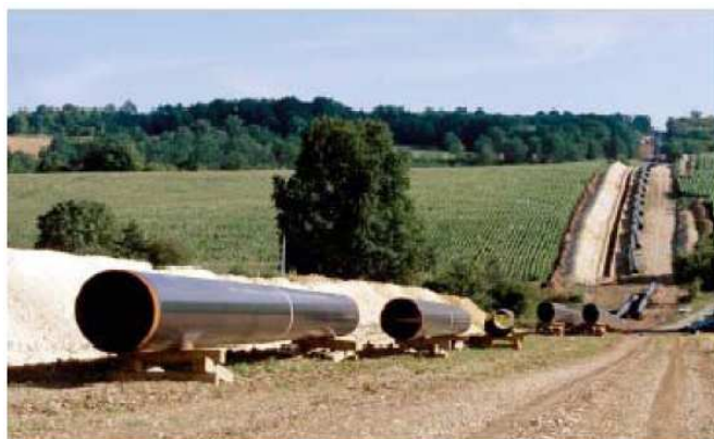
Figura 3.2. Tubulações para transporte de CO 2 . (LEAL DA COSTA, 2009)
