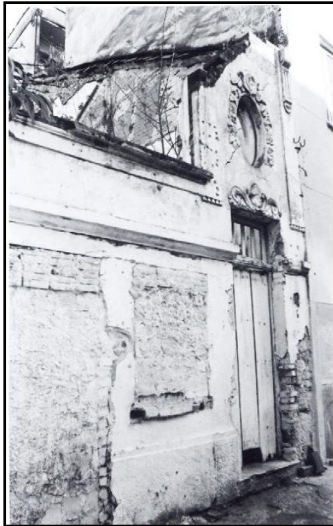
Imagem 7 - Fachada em ruínas do sobrado na rua Riachuelo. Sítio Casa da Riachuelo. Fotografia: CCS/PMPA (TOCCHETTO, 2004).
