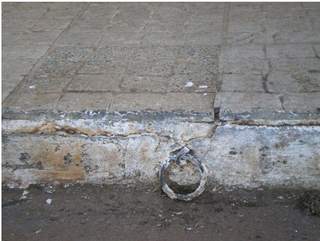
FIGURA 91 - Argola em ferro chumbada no cordão do passeio em frente a uma empresa comercial. Rua General Salvador Pinheiro
