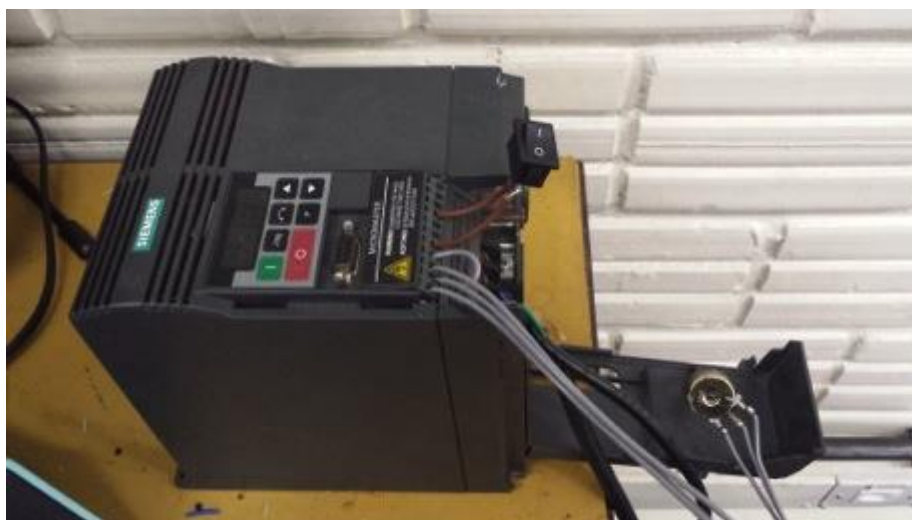
Figura 27 - Inversor de Frequência SIEMENS MICROMASTER 6SE9216-8CB40.
