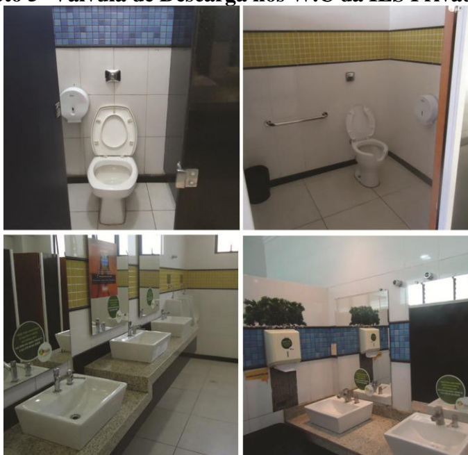
Foto 5- Válvula de Descarga nos W.C da IES Privada
